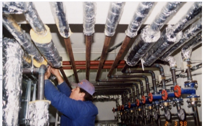
Heizungsverteiler, Gästehaus Felsenkopf in Queidersbach
