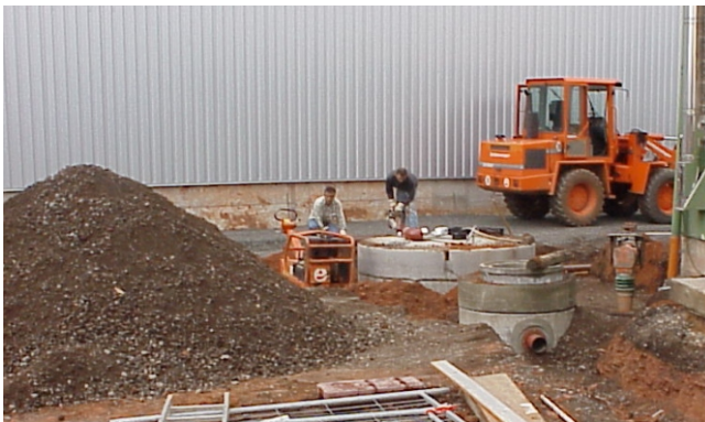
Koaleszenzabscheider, Tankstelle Dieselkraftstoff - Sembach
